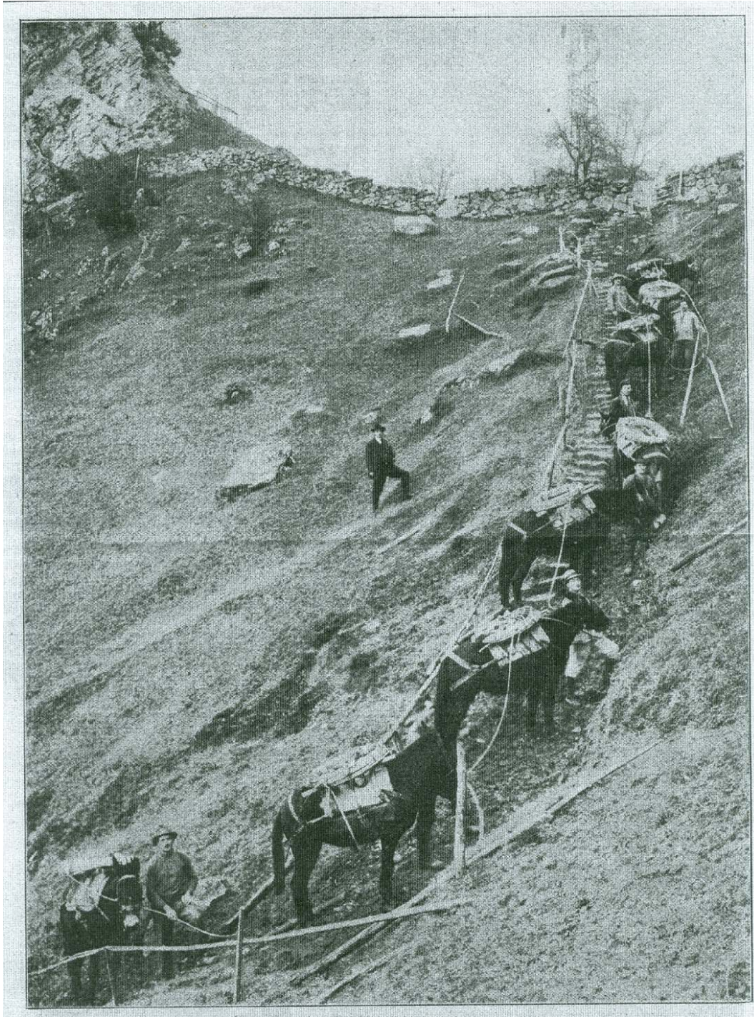
Transport eines Kabels für die Starkstromleitung am oberen Axenberg am Urnersee. Das transportierte Kabel ist 500 Meter lang. Das erforderte eine hohe Koordination der beteiligten Säumer und Maultiere. (Schweizer Familie, 1922 [Meier 2015, 23]).
